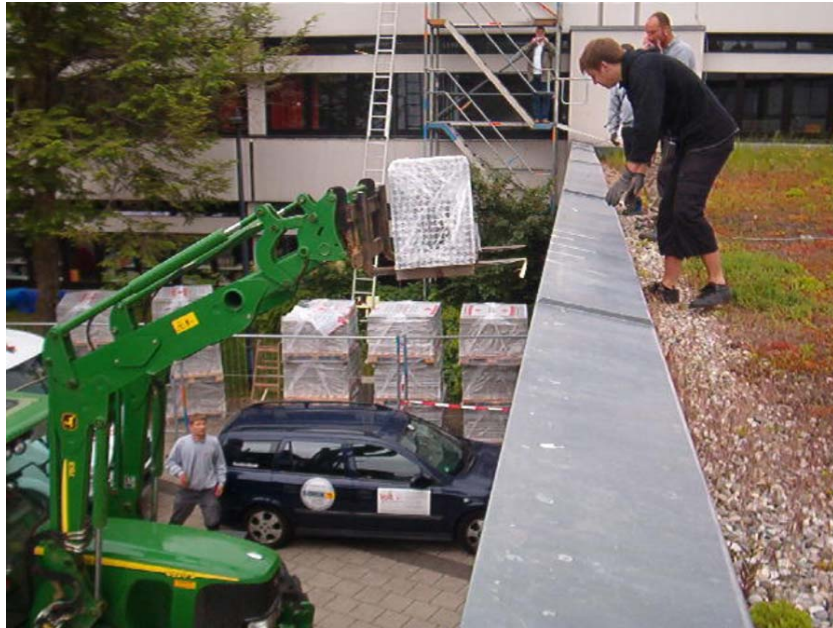
Aluträgerkonstruktion für Solarmodule zur Zwischenlagerung auf unterem Dach
