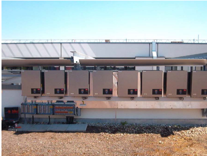
Der komplett fertig gestellte Wechselrichterplatz
