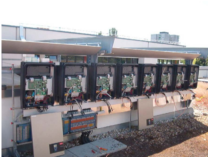
Verdrahtung der Wechselrichter und Datenleitungen zur Anlagenauswertung über das System Solar-Log
