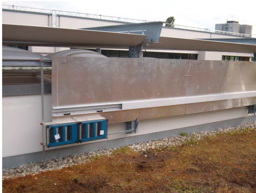
Wechselrichterplatz mit Aluminiumplatten zur Stabilisierung und Montage der Wechselrichter
